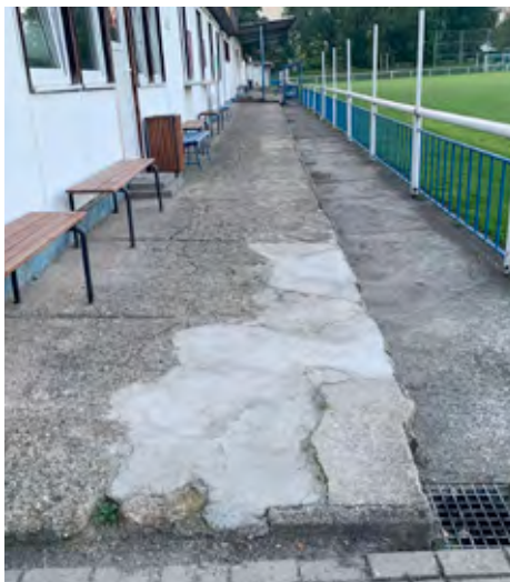
Chodník podél kabin MSK čeká opravu.
