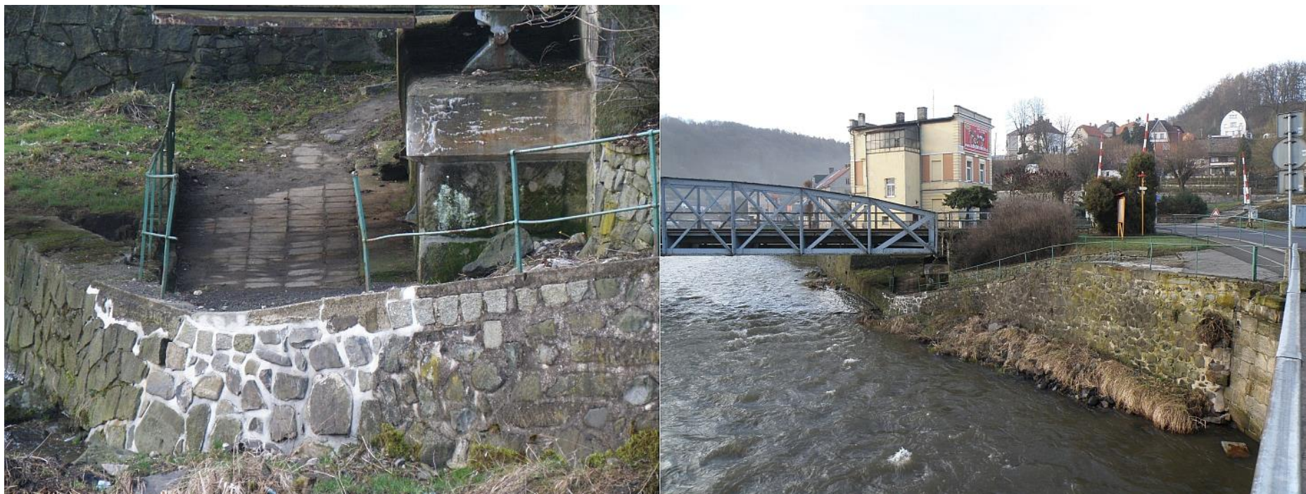
Poškozené zábradlí u podchodu pod železniční tratí.
