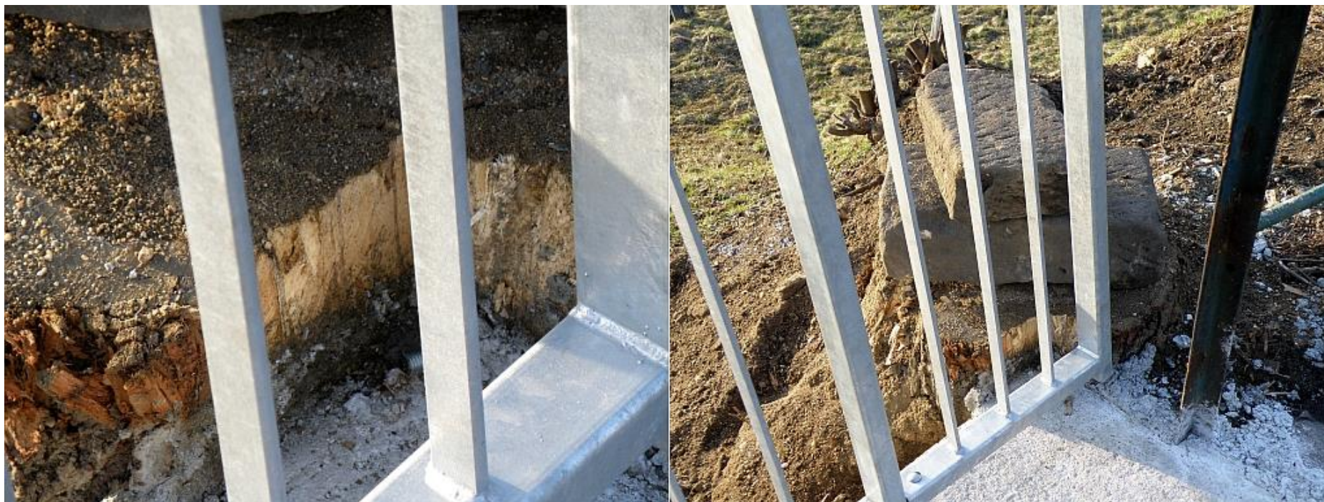
Nově budovaný most přes železniční trať na českou Lípu v ulici Sokolský vrch.
