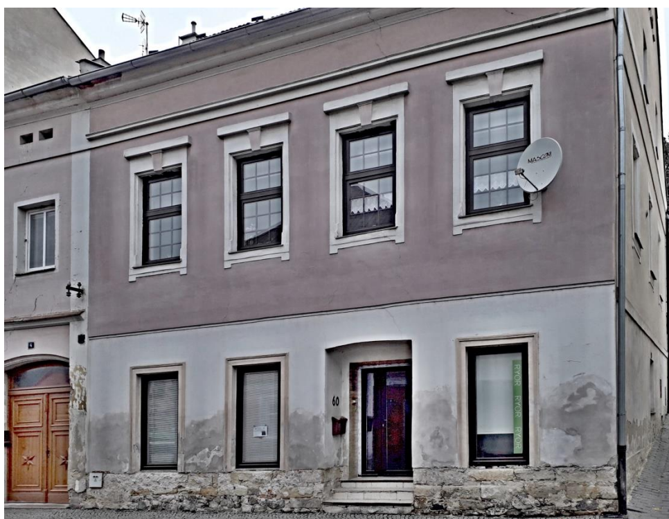
Náměstí Míru čp.60. Vzlínání omítky v základové části.
