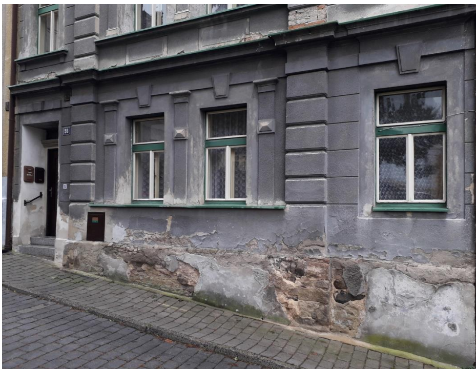
ul. U Studánky čp.60. Vzlínání omítky v základové části.
