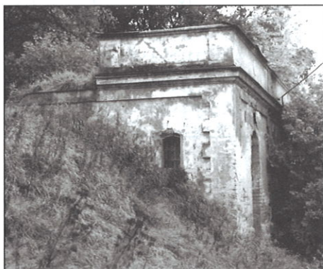
Velmi špatný stav městského vodárenského zařízení - před předáním do SVS.
