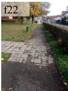
Bariérový úsek chodníku v Děčínské ulici /velké nerovnosti/.
