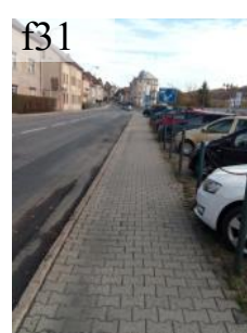
Částečně bezbariérový chodník v Děčínské ulici /malé nerovnosti, zadržování srážkové vody/.
