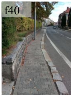
Bariérový úsek chodníku v Děčínské ulici /úzký chodník, nerovnosti, sloup veřejného osvětlení bez kontrastního označení/.
