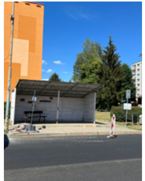
Stará autobusová zastávka se opravy nedočká...
